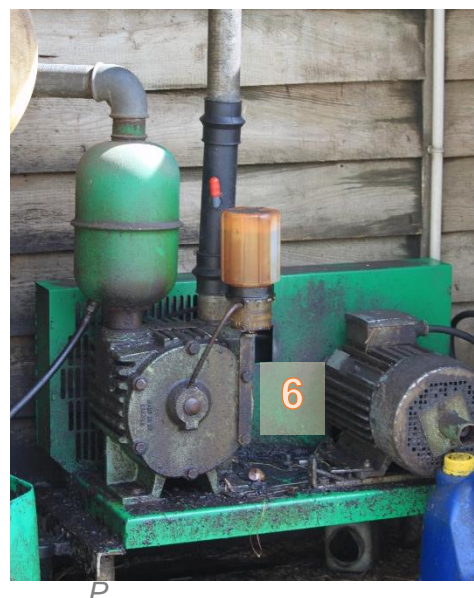
Photo 1 : pompe à vide
