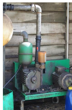
Photo 5 : Pompe à vide
