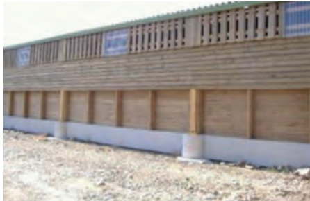
Photo 12 : le bardage claire-voie coulissant permet de moduler les entrées d'air.
