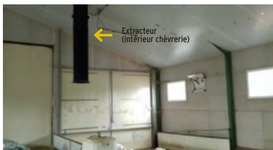
Photos 18 et 19 : La ventilation dynamique par extraction fonctionne avec des extracteurs installés dans des cheminées.
