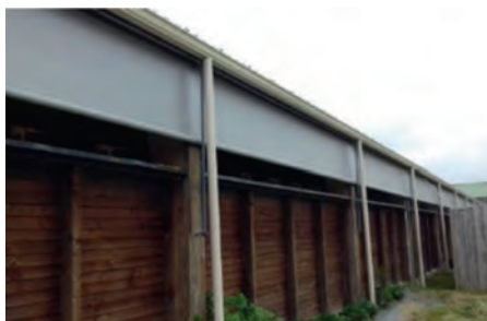
Photo 14 : les rideaux mobiles enroutables peuvent s'activer automatiquement.
