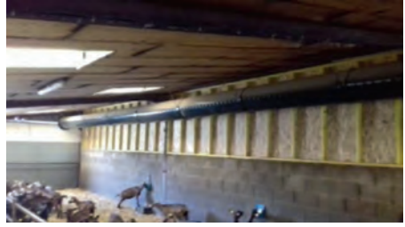
Photo 25 : la ventilation dynamique par surpression est recommandée pour les nurseries en appentis.
