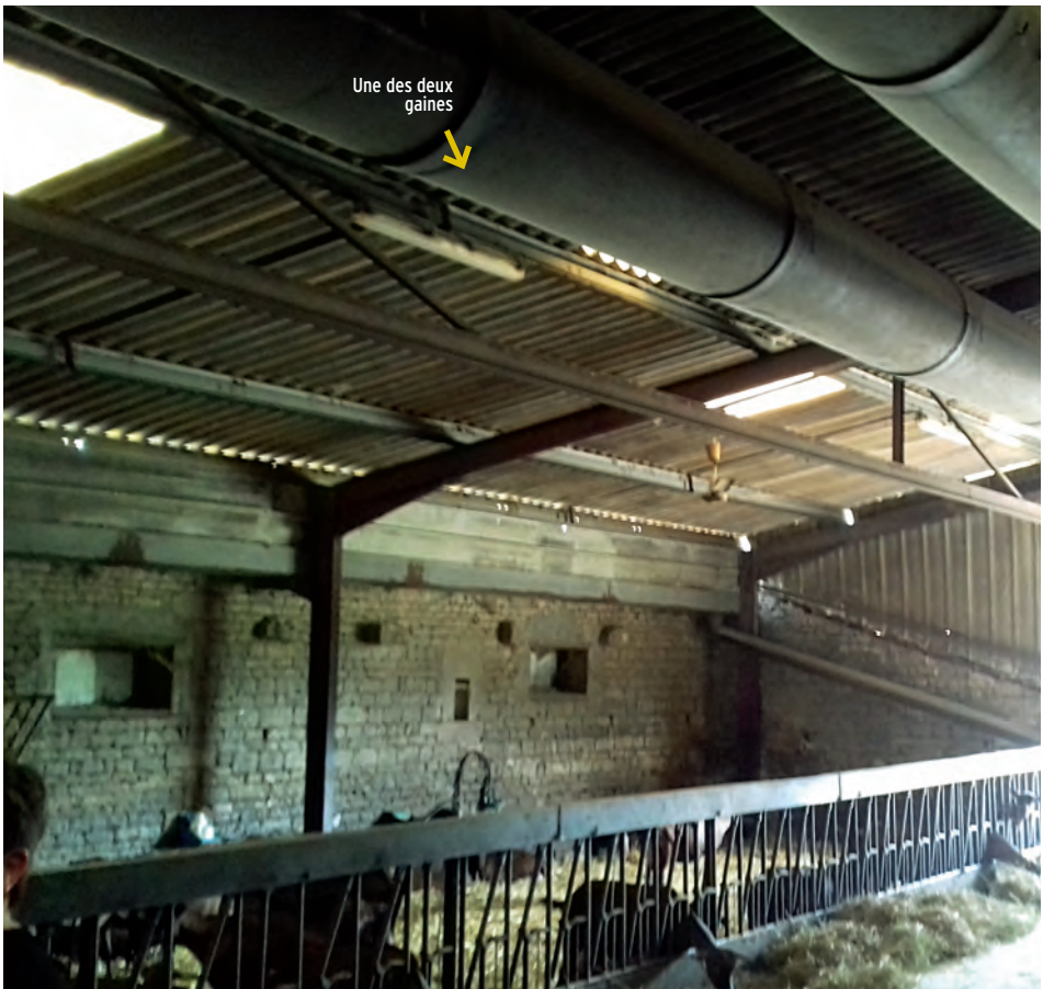
Photos 22 : les gaines d'entrée d'air occupent toute la longueur de la chèvrerie .
