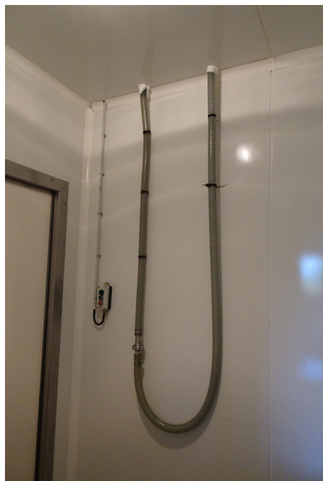
LAVAGE EN CIRCUIT FERMÉ AVEC UNE POMPE
