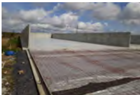
Photo 30 : Silo de stockage des ensilages avec trois murs périphériques en parois auto-stables (crédit photo : Idele)
