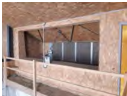
Photo 39 : Trappe de ventilation (crédit photo: Segrafo)
