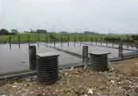
Photo 52 : Lagunage (crédit photo : CAHDF)
