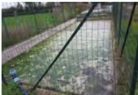
Photo 49 : Un exemple de traitement primaire : le Bassin Tampon Sédimentation (crédit photo : CAHDF)
