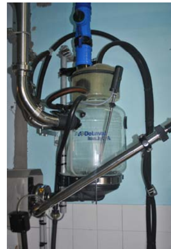
Matériel de traite propre : bon nettoyage intérieur et extérieur du bocal de réception
