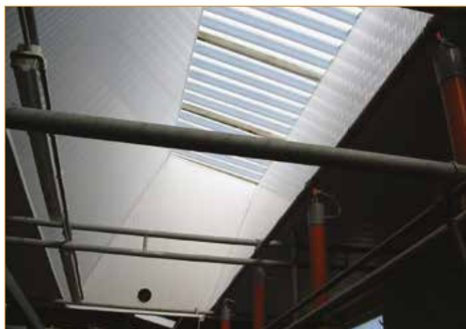
Photo 94 : Un puit de lumière, ici localisé dans une salle de traite, apporte un éclairage naturel complémentaire.
