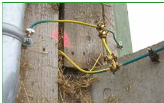
Photo 61 : Liaisons équipotentielles entre les poteaux métalliques de la charpente et les dalles d'évacuation des eaux de toitures.
