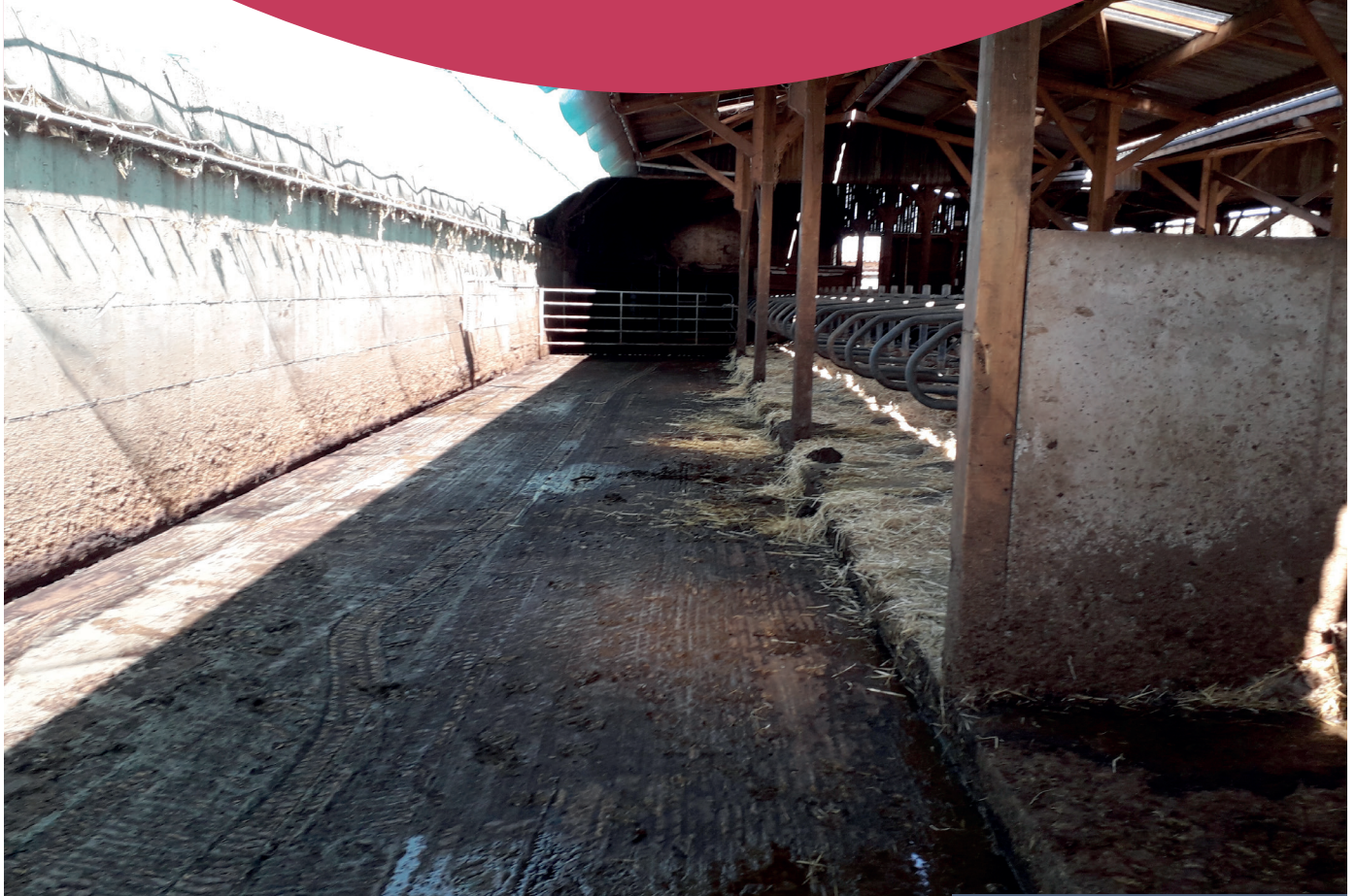
Photo 21 - Filet fermé en période froide
