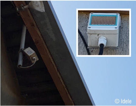
Photo 28 : Dans cet élevage, chaque façade est équipée d'un capteur de pluie permettant de fermer partiellement le rideau lors de précipitations.
