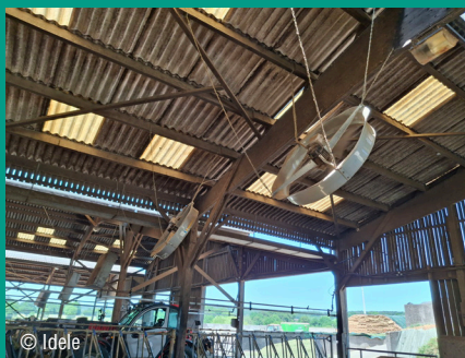
Photo 35 : L'installation de ventilateurs vient après l'ouverture des côtés et la réduction du rayonnement direct et indirect du soleil.
