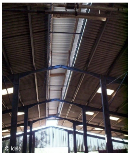
Photo 5 : Un lanterneau permet une grande ouverture en faîtage.
