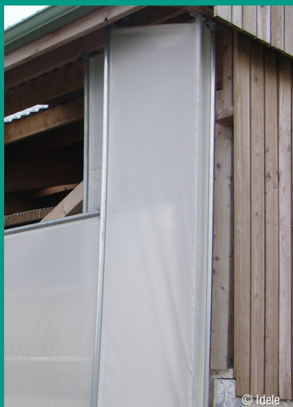
Photo 16 : Protection du mécanisme d'enroulement.
