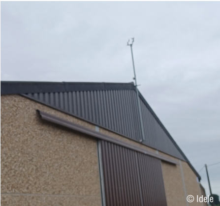
Photo 27 : L'anémomètre installé au niveau du faîtage permet d'enregistrer la vitesse et l'orientation du vent.
