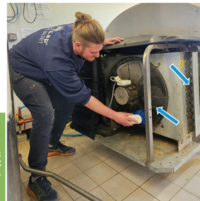
LE NETTOYAGE COMPLET ET RÉGULIER DU CONDENSEUR PERMET UNE MOINDRE CONSOMMATION ÉLECTRIQUE DU TANK.
