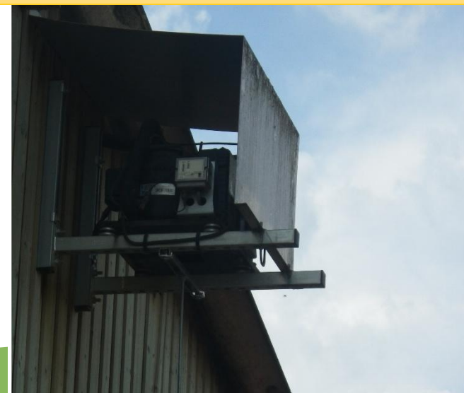
LE COMPRESSEUR EST PLACÉ EN EXTÉRIEUR, À L'ABRI ET AÉRÉ.
