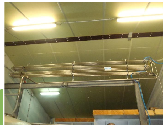
PRÉ-REFROIDISSEUR PLACÉ AU-DESSUS D'UN TANK
