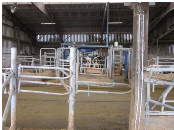
Photo 15 : Portes de tri automatiques et anti-retour à Derval
