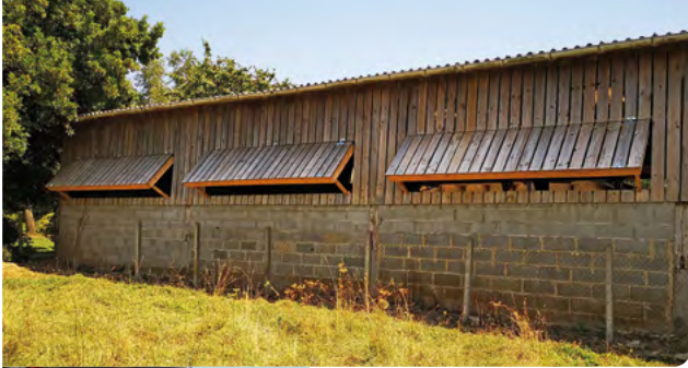
Une solution à moindre coût : ouvrir des trappes sur le bardage
