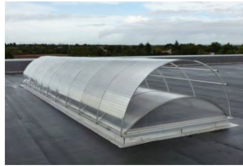
Protection solaire extérieure
