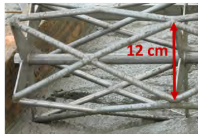
Illustration de sa mise en œuvre à l'aide d'un rouleau (réalisée par un professionnel). Source : SICA de maçonnerie des Couëvrons (53)
