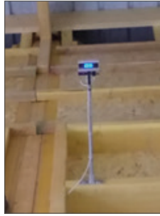
Figure 13 : Un exemple de sonde mesurant la température et l'humidité de l'air ambiant dans le caisson de ventilation
