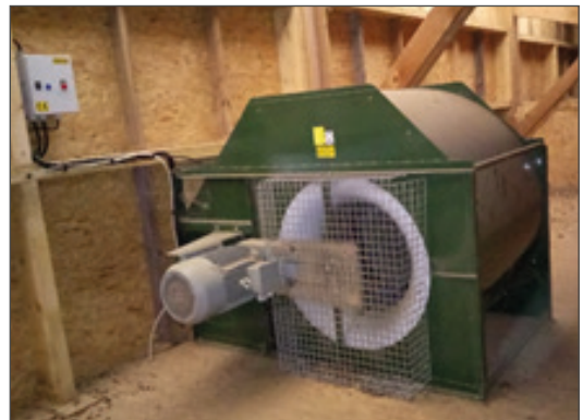
Figure 10 : Bien penser à l'accessibilité du ventilateur !
