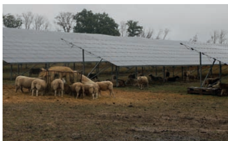
Photo 42 : Exemple de système d'affouragement rencontré en parc photovoltaïque (© B. Morel)
