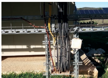
Photo 36 : Câblages laissés apparents (©Idele)
