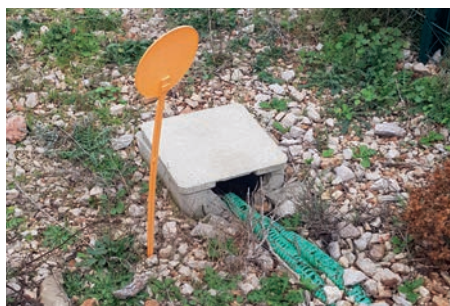
Photo 37 : Exemple de regard pouvant être présent dans un parc photovoltaïque (©Idele)
