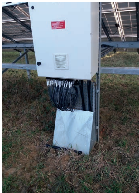
Photo 33 : Câblages électriques laissés apparents à faible hauteur pouvant être rongés par les animaux (© Idele)
