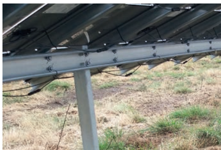
Photo 38 : Exemple de fixation de câbles électriques avec des serre-câbles à l'arrière d'un panneau photovoltaïque (©Idele)
