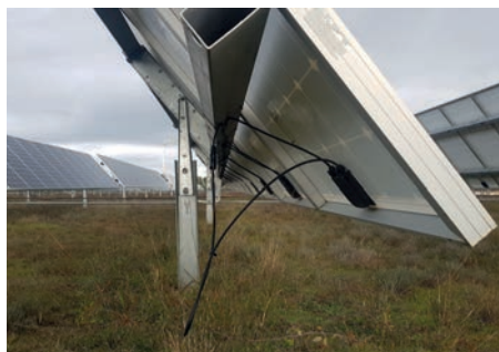
Photos 34 et 35 : Les câbles électriques ont tendance à pendre à faible hauteur, à l'arrière des panneaux, engendrant un risque d'étranglement, en particulier chez les jeunes animaux. (©Idele)
