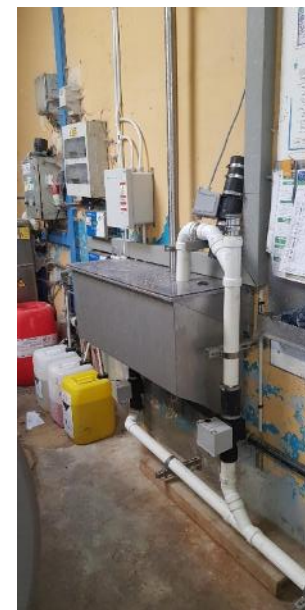
Automate et bac de lavage à La Blanche Maison
