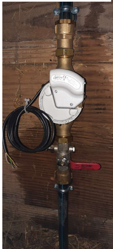
Figure 2 : Compteur d'eau à impulsion
