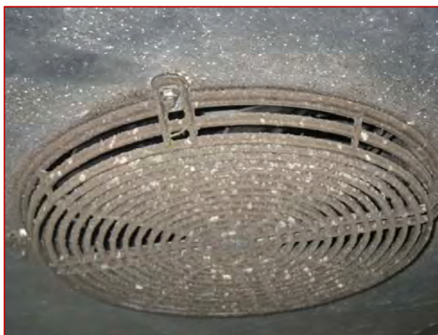
Photo 1 : évaporateur encrassé par des moisissures et des poussières
