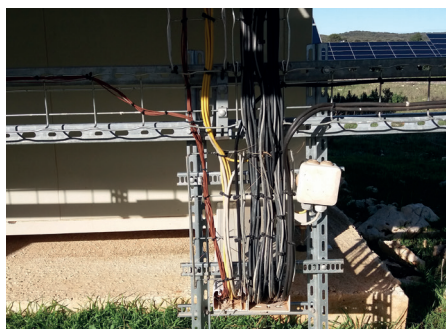
Photo 32 : Câblages laissés apparents (© Idele)
