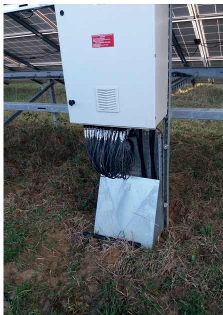
Photo 29 : Câblages électriques laissés apparents à faible hauteur pouvant être rongés par les animaux (© Idele)
