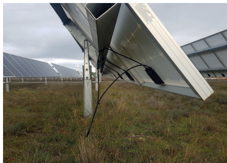
Photo 30 : Les câbles électriques ont tendance à pendre à faible hauteur, à l'arrière des panneaux, engendrant un risque d'étranglement, en particulier chez les jeunes animaux. (©Idele)
