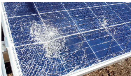
Photo 22 : Panneau photovoltaïque endommagé (© Andrei Merkulov/AdobeStock)
