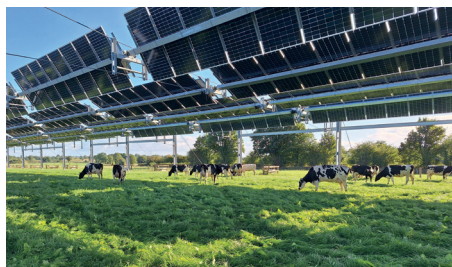
Photo 12 : Ombrières photovoltaïques à Souleuvre-en-Bocage (14) (@TSE)
