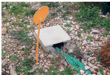
Photo 33 : Exemple de regard pouvant être présent dans un parc photovoltaïque (© Idele)
