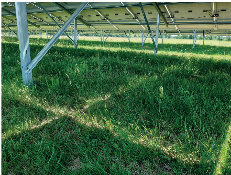
Photo 47 : Centrale agrivoltaïque de Bioule (82) (© Idele, centrale gérée par Neoen)
