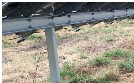
Photo 31 : Exemple de fixation de câbles électriques avec des serres-câbles à l'arrière d'un panneau photovoltaïque (©Idele)
