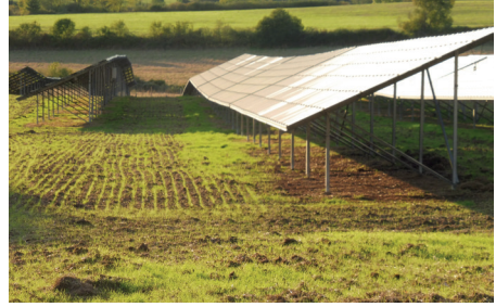
Photo 45 : Prairie semée dans un parc photovoltaïque (© Photosol)
