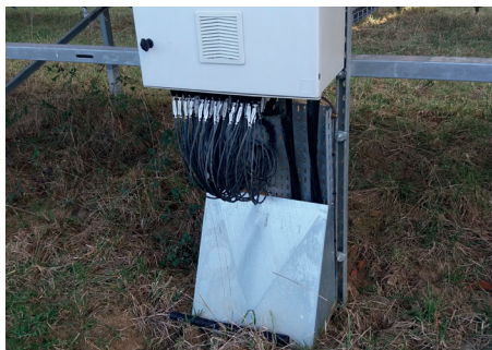
Photo 50 : Présence de câbles à 50 cm de haut, risque d'endommagement de la structure sans protection (© Idele)
