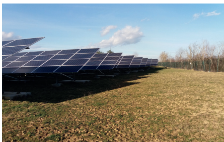
Photo 46 : Centrale photovoltaïque de Sainte-Agathe La Bouteresse (© Idele)
