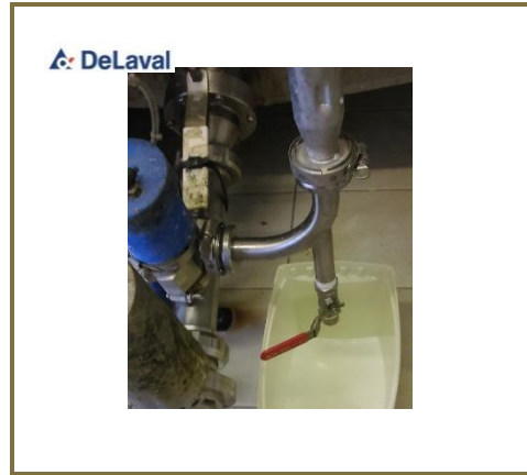
Photo 3 : Dispositif de prélèvement entrée tanks pour robot DeLaval
