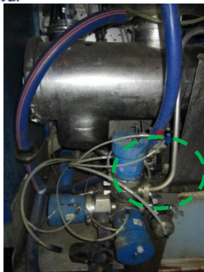
Photo 6.1 : Localisation P3, sur le lactoduc d'évacuation, après la pompe à lait et les vannes de tri pour robots DeLaval
