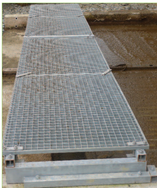
Photo 15 : Protection au-dessus d'un canal à lisier.
