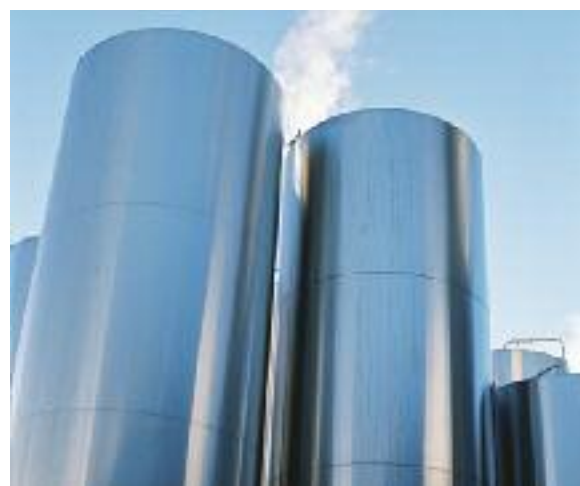
Cuves de stockage du lait
