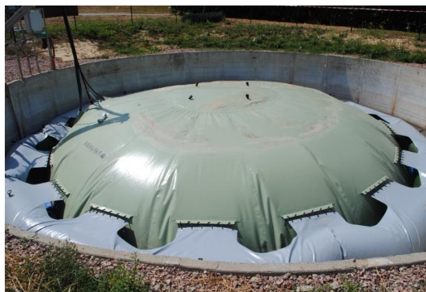
4 septembre 2018 : Mise en route
