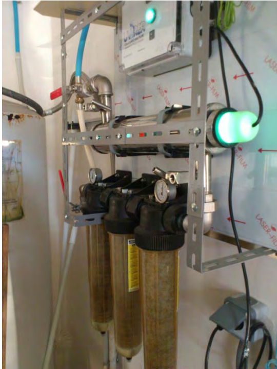
Figure 5 : Photo d'un dispositif de traitement de l'eau par rayonnement UV et filtration amont à la station expérimentale du Pradel
