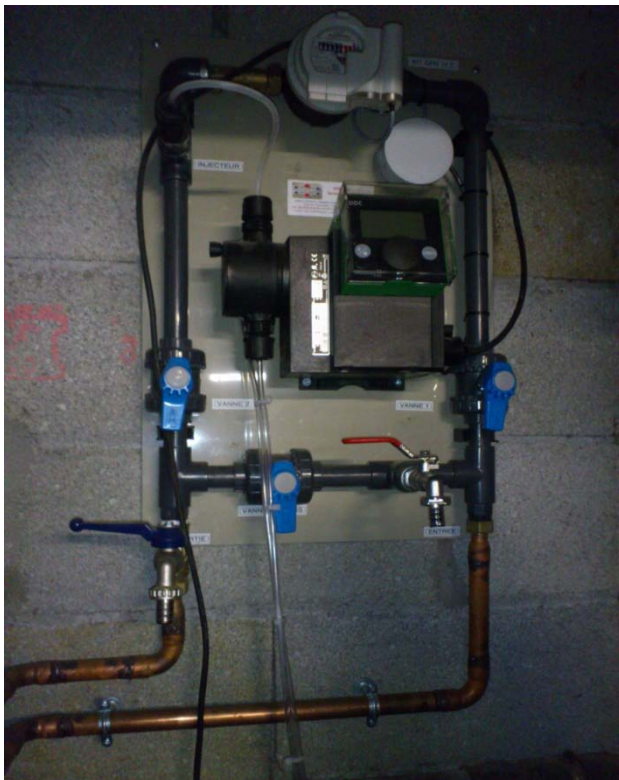
Figure 6 : Photo d'un dispositif de traitement de l'eau par injection de peroxyde d'hydrogène dans l'eau par un système de pompe doseuse à la station expérimentale du Pradel
