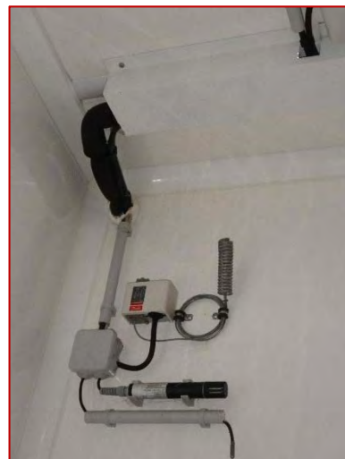
Photo 22 : sonde de mesure pour la régulation des équipements de climatisation (hygromètre capacitif) Source : C. Reynaud, Actalia Produits Laitiers
