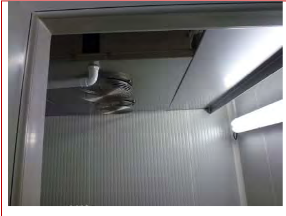
Photo 13 : Ventilateurs de reprise dessous un évaporateur dans un séchoir avec un faux plafond conduisant l'air soufflé Source : M. Pétrier, CTFC
