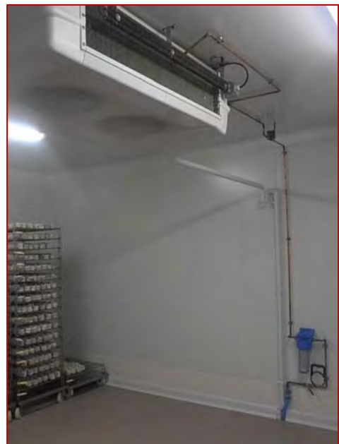
Photo 10 : humidificateur sur l'évaporateur dans un hâloir Source : S. Morge, PEP caprins Rhône-Alpes
