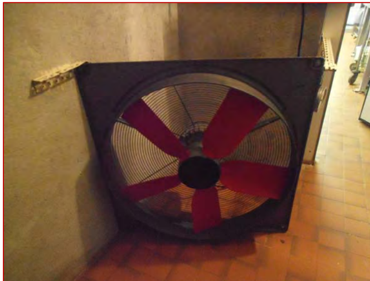
Photo 15 : ventilateur additionnel indépendant dans un séchoir Source : S. Morge, PEP caprins Rhône-Alpes
