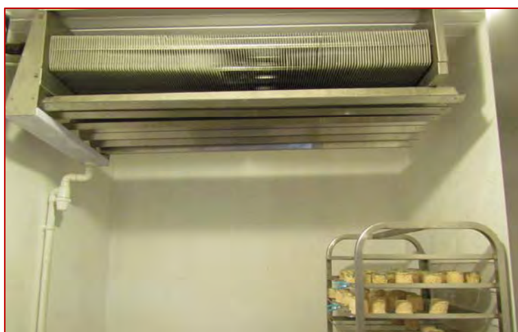
Photo 5 : évaporateur à détente directe statique – Source : G. Allut, CFB
