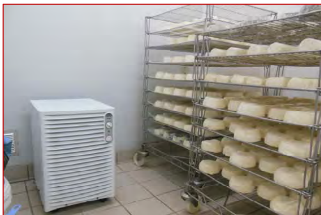
Photo 23 : déshumidificateur externe dans un hâloir Source : A. Chabanon, FRESYCA
