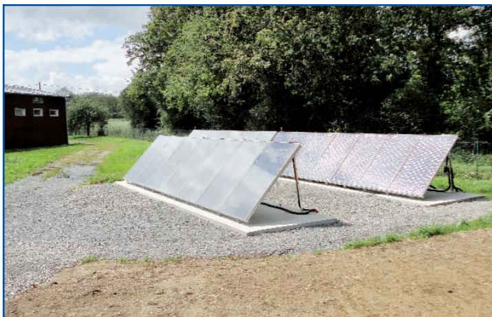
Les panneaux solaires thermiques utilisés pour la production d'eau chaude sont éligibles au dispositif «fonds chaleur» de l'ADEME
