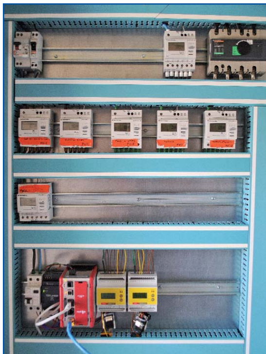
22 compteurs électriques et compteurs d'eau gérés par une centrale d'acquisition
